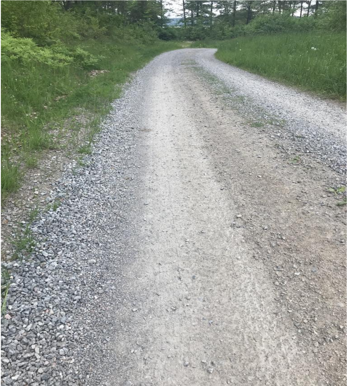
Sättning på Utfjärdsvägen
